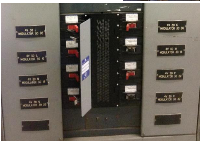
Fenêtre personnalisée CAP-CT en position ouverte pour l'inspection IR du côté charge des disjoncteurs
