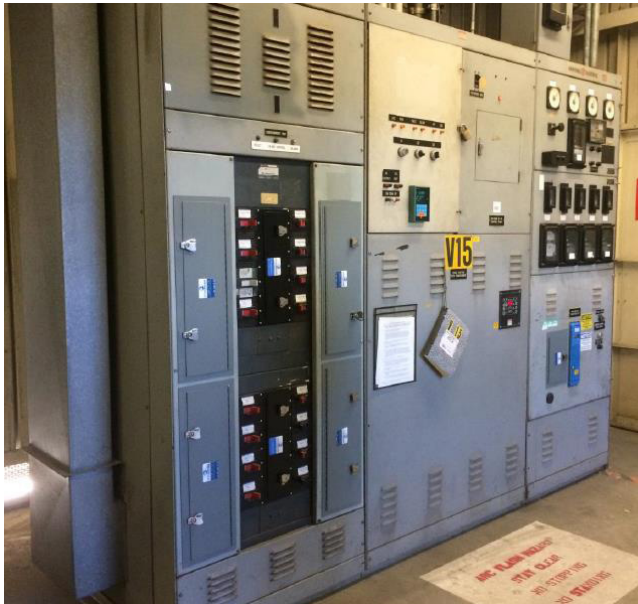
Installation finale montrant les 7 fenêtres IR installées
