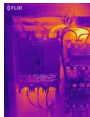
Identifiez les défaillances électriques
