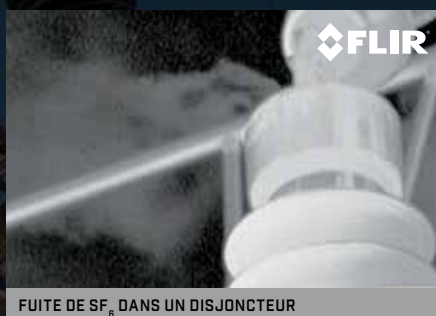
FUITE COURANTE DE SF 6 SUR UN RÉSEAU
