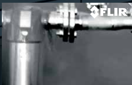
FUITE DE CO 2 - IMAGE INFRAROUGE
